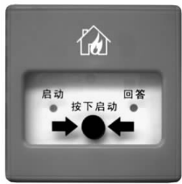
图 3.1.6 消火栓报警按钮 ①
