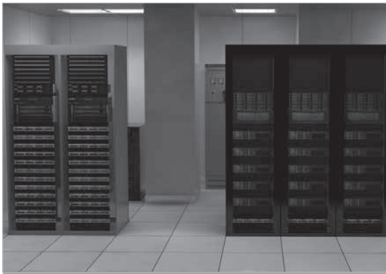
图1-2 某大型计算机机房
