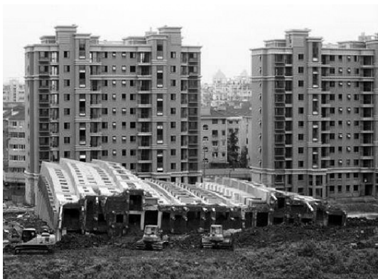
图4.2 “莲花河畔景苑”小区内倒塌的建筑
